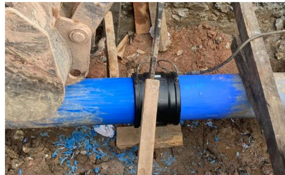
ELETROFUSÃO EM INTERLIGAÇÃO (COMO NÃO FAZER!)
