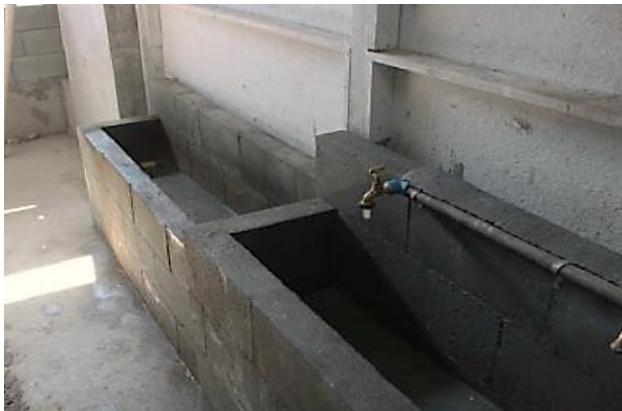
Reuso de águas cinzas do lavatório para o mictório
