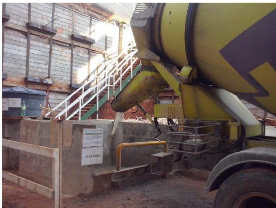
Lava rodas com sistema de decantação e reaproveitamento em lava bicas
