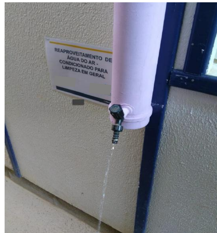
Reaproveitamento de água do ar condicionado
