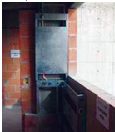
FIGURA 18 CARENAGENS METÁLICAS PARA OCULTAR TUBULAÇÕES, MINIMIZANDO RECORTES.
