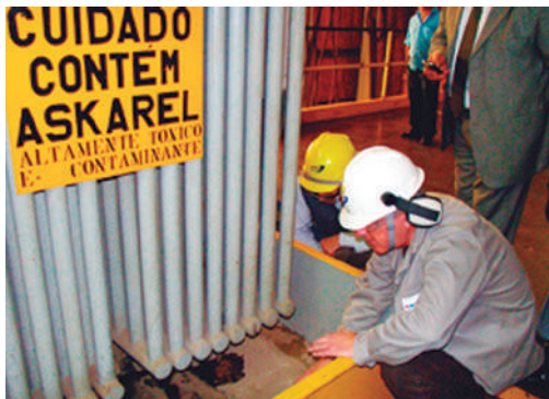
Equipamentos elétricos antigos (com PCBs)
