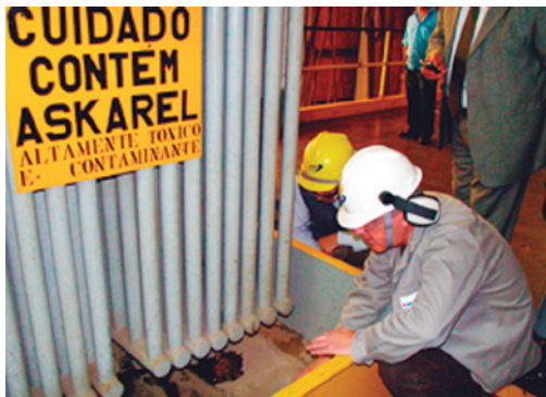
Equipamentos elétricos antigos (com PCBs)
