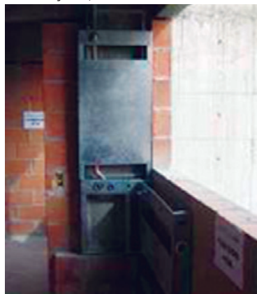
FIGURA 18 CARENAGENS METÁLICAS PARA OCULTAR TUBULAÇÕES, MINIMIZANDO RECORTES.
